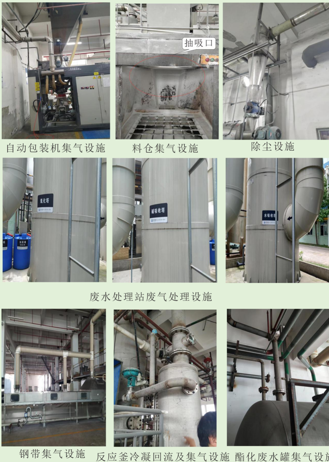
图 3.7-1 现有企业企业废气收集处理设施现状图
