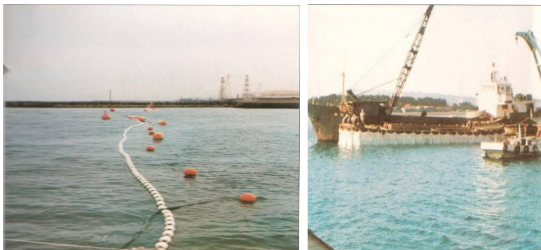
a 防污屏围护电厂取水口
